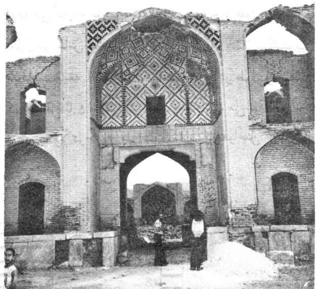
عکس شماره ۴۲- کاروانسرای مرنجاب کاشان شکست چفد بخصوص در ناحیه تیزه
