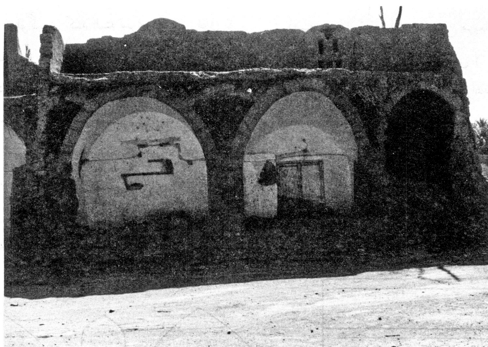
عکس شماره ۳۱- یکی از روستاهای فضل آباد بین راه بم به زاهدان - نرماشیر یک نوع کنوسازی که در اینجا کنو در همان جهت طاق اصلی زده شده است (عکس از مهندس مهریار)
